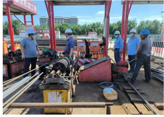
现场及生活区临时用电检查
