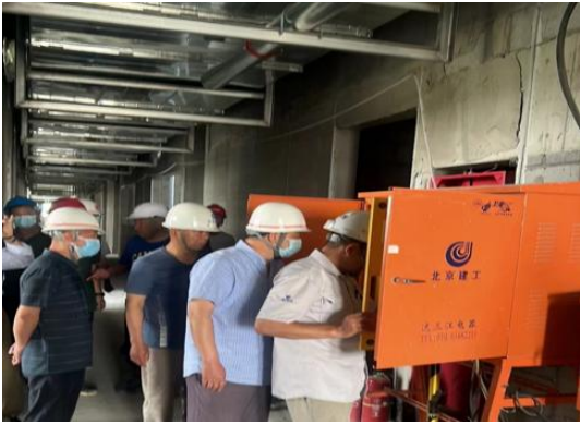
临电安全检查
